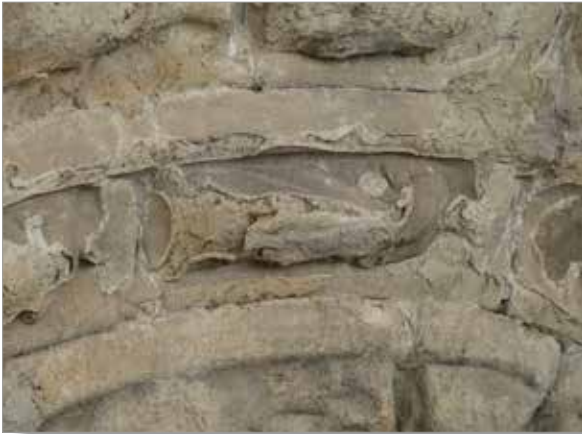
Detailaufnahme mit Schadensbild
