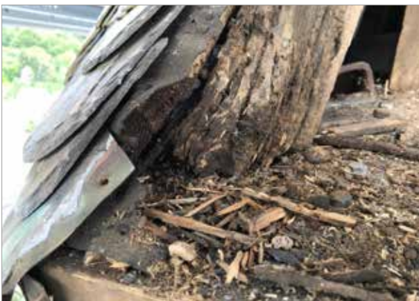
Fäulnis zersetzt die Bindungsstellen
